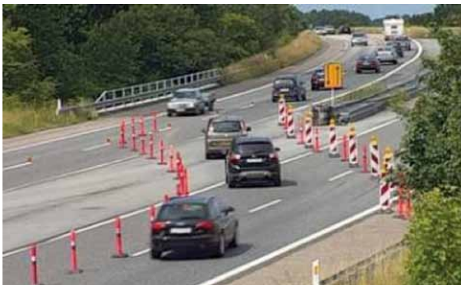
Figur 3. En række med 10 gule blinklamper på baggrundsafmærkning N42 afgrænser højre side af kørearealet ved trafikoverledning på motorvej.
