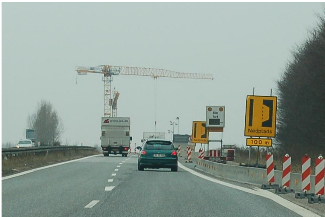
Foto 3 Ca. 50 m før rumlestriberne.
