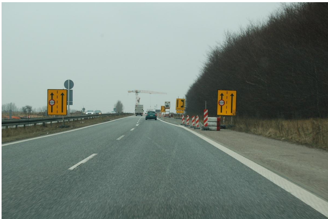
Foto 2. Ca. 100 m før rumlestriberne
